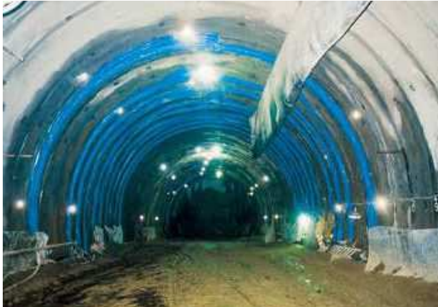
トンネル裏込排水
